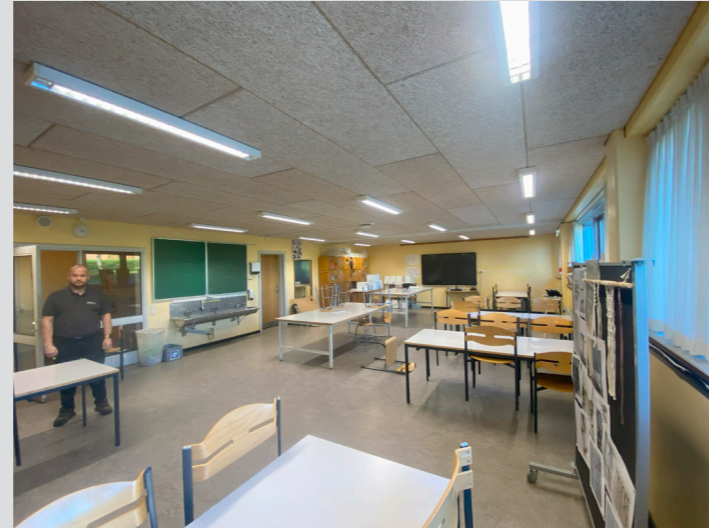
Tekstilværkstedet i håndværk og design fremstår utidsvarende med dårlig kobling til træværkstedet.
