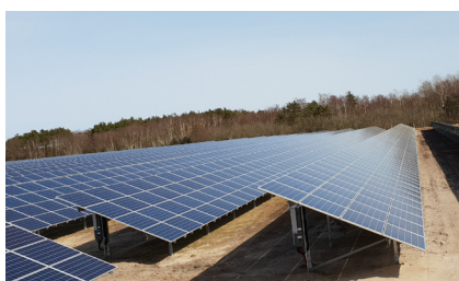
Solpaneler monteret på faste stativer
