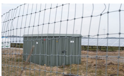
Eksempel på teknikbygning - transformerkiosk
