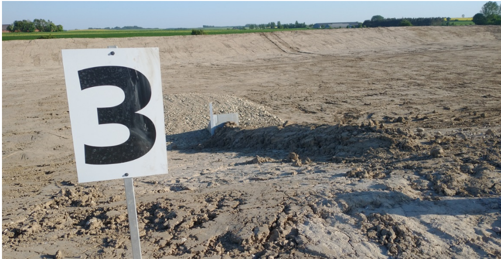
Billede 2. Der er stillet tydelige markeringer af de forskellige bassiner op ved bygningsværkerne til levering af spildevand, så vognmænd/entreprenører kan orientere sig.
