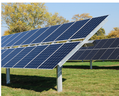
Eksempel på solcellepaneler på stativer med trackermekanisme.
