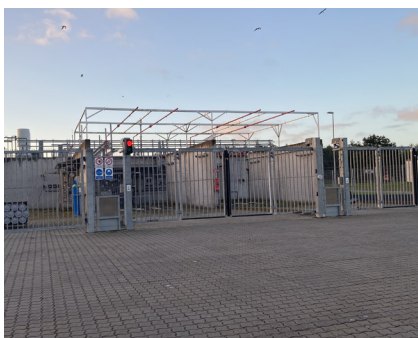
Eksempel på elektrolyseanlæg.
